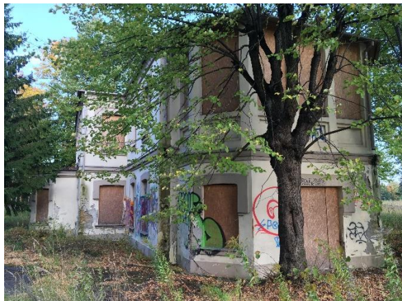
8. attēls. Divstāvu ēka Ventspils ielā 63D (atrašanās vietu skatīt 5. attēlā). Avots: SIA "METRUM", 2017.
