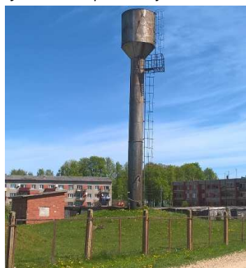
Attēls 44: Ūdenstornis ar artēzisko urbumu Biržu ciemā (foto P. Grants 8.05.18.)
